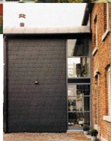
Bardage dérivé du ciment
